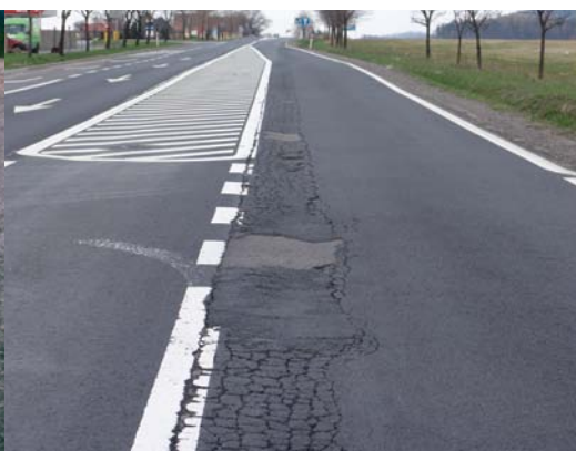
Fessurazione da fatica
